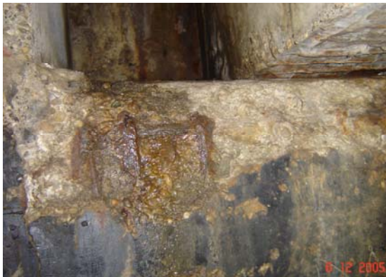
Оштећење лежине греде
