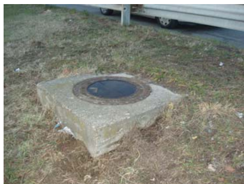
Слика 1 и 2 : Стање већине шахтова за одводњавање аутопута Е-75 – пролаз кроз Београд
