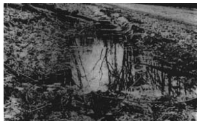
Слика 2: Пример неадекватне дренаже високог нивоа оштећености
