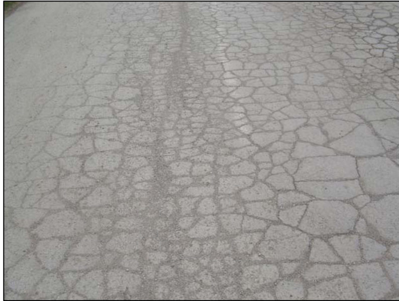
Слика 3. – „Крокодилске љукошине“ на асфалтном засипору
