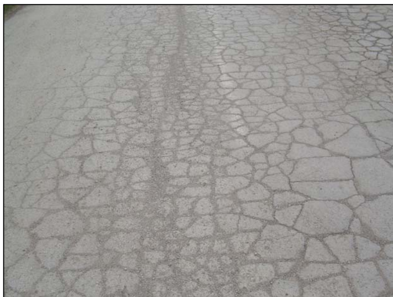
Слика 3. – „Крокодилске љукошине“ на асфалтном засипору
