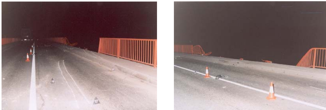
Slika 4: Primer probijene pešačke ograde na mostu posle saobraćajne nezgode
